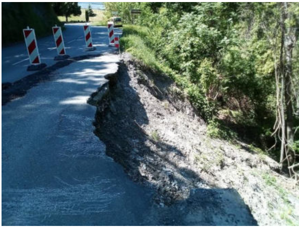
RD94 PR2+590 sous St Oyen - glissement
