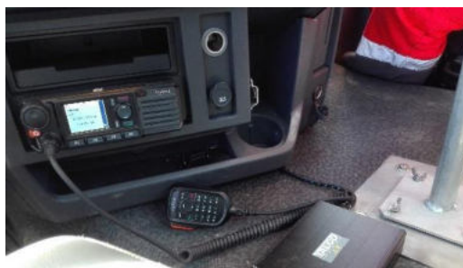
Antennes relais et équipement véhicule réseau radio
