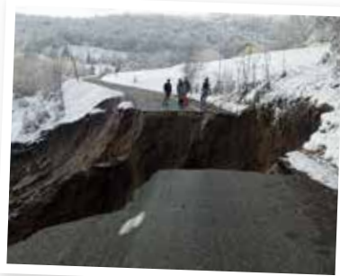
Route emportée à Gerbaix (RD35)
