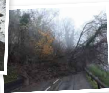
Éboulement sur la route de Châteauneuf (RD202)
