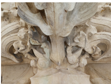
Détails des altérations de la pierre.
